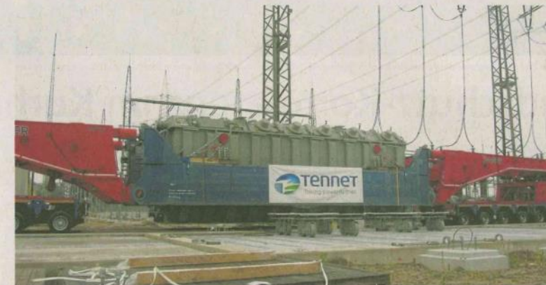
Ein Schwertransport lieferte im vorigen Jahr einen neuen Transformator ins Umspannwerk Stadorf. Ab 2027 soll eine neue Hochspannungsleitung quer durchs Kreisgebiet gebaut werden.
